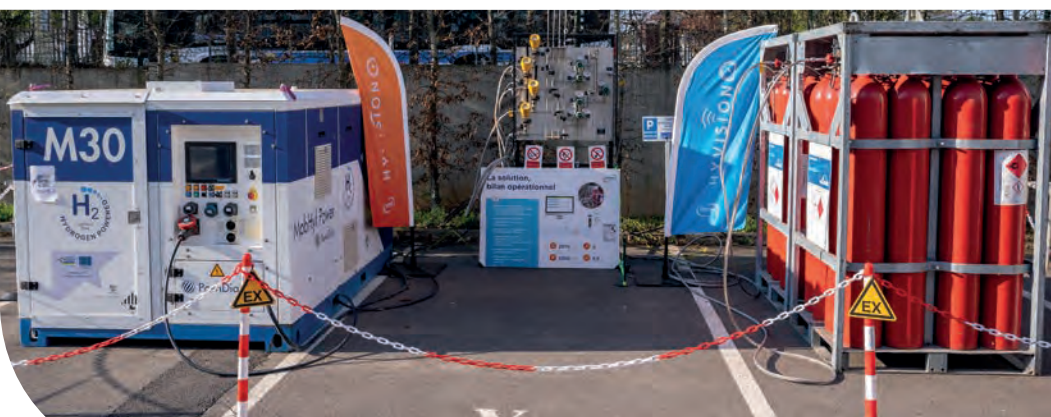
La solution Hyvision déployée par Bouygues avec un générateur électrique à hydrogène (ici un générateur PowiDian)
